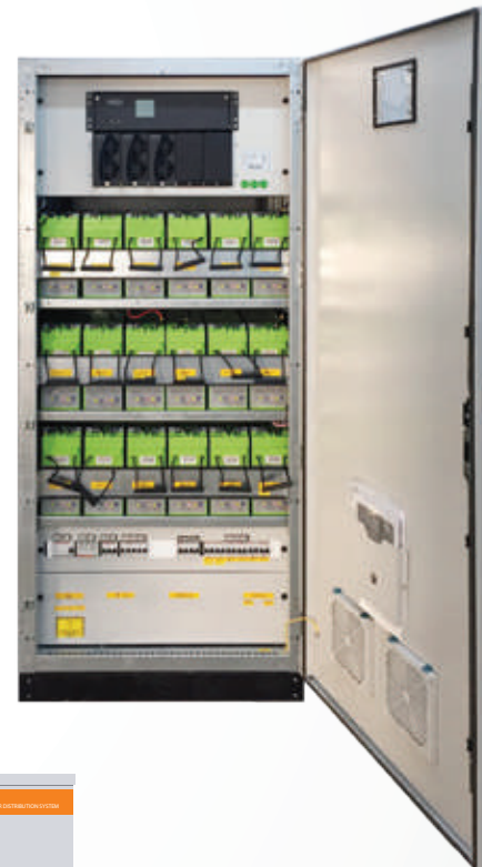
Système DC 110v/200A, évolutifs et remplaçables à chaud, logés dans des armoires IP41 avec 2 groupes de batteries 12V et accès à distance.
